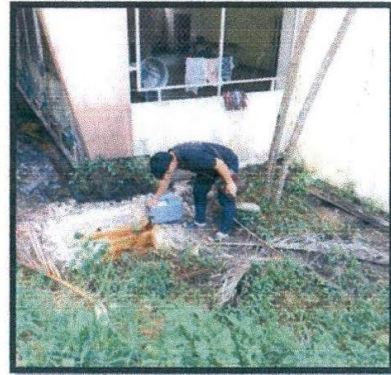
การเติมจุลินทรีย์ในบ่อดักไขมัน
